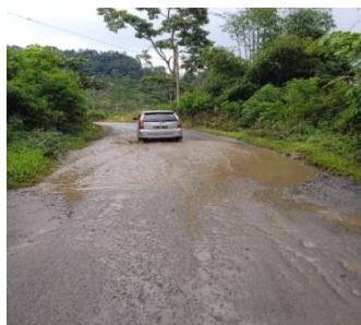
Gambar 4. Kondisi Jalan Rusak di Desa Telagah Sumber: Dokumentasi Peneliti, 2024
